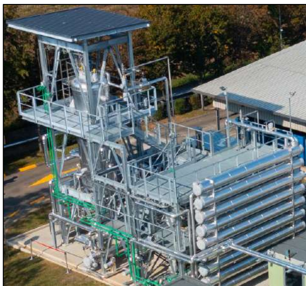
Figura 16: Reattore HTC e scambiatori di calore.
