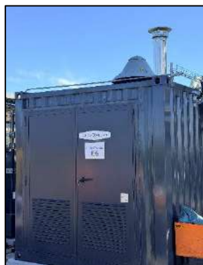
Figura 22: Locale caldaia, E6
