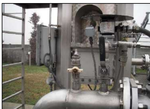
Figura 24: Beccuccio di prelievo del biogas
