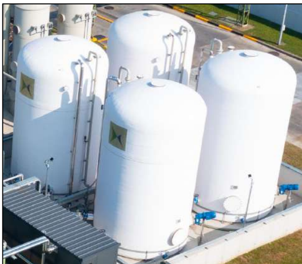
Figura 15: Serbatoi stoccaggio fanghi sez. HTC
