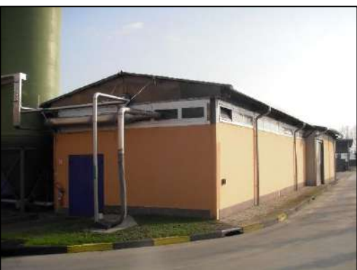
Figura 13: Locale filtpresse disidratazione fanghi biologici e chimici
