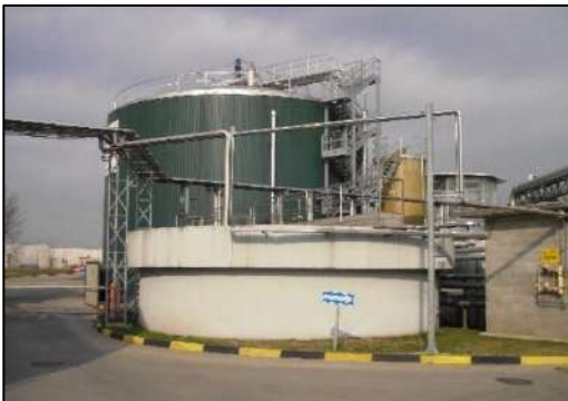
Figura 12: Ispessitore e digestore fanghi biologici
