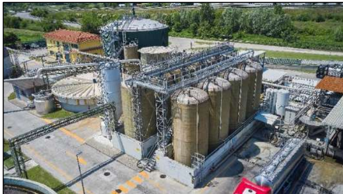
Figura 9: Serbatoi di stoccaggio (reflui e reagenti)
