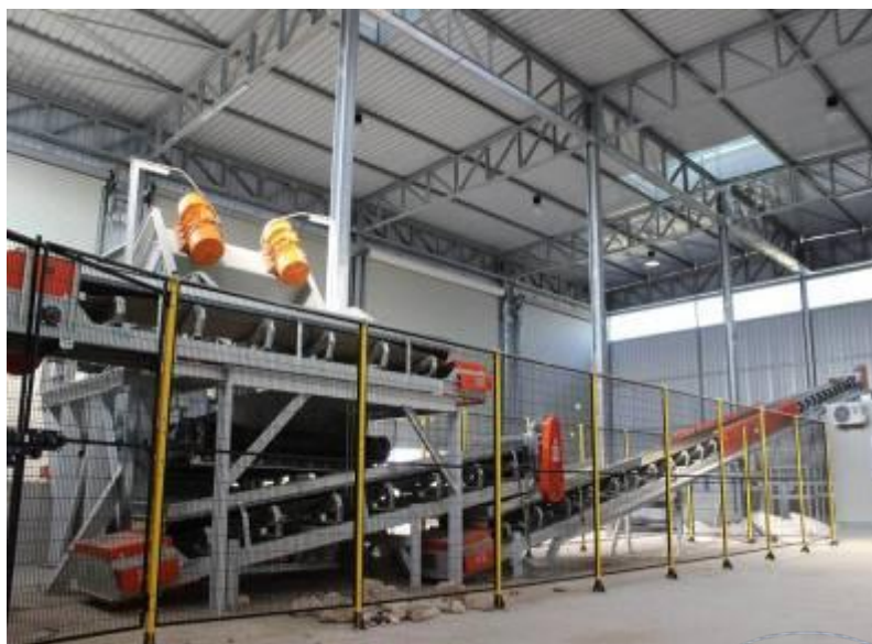
Fig. 5.5 – Impianto di trattamento rifiuti.
