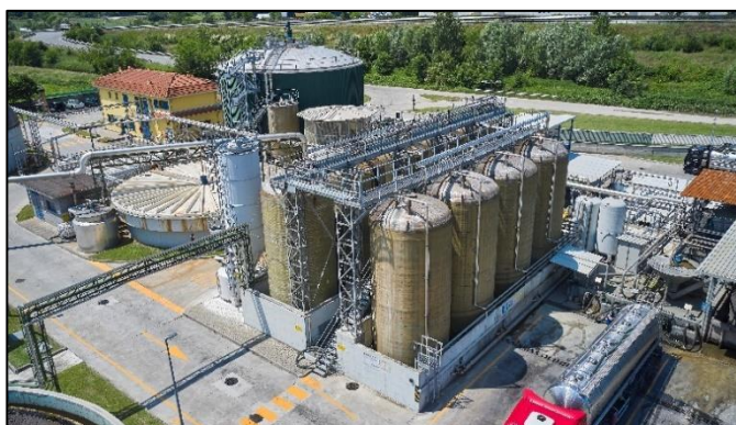
Figura 9: Serbatoi di stoccaggio (reflui e reagenti)
