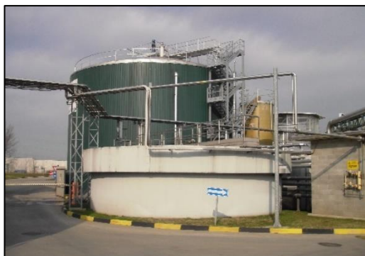
Figura 12: Ispessitore e digestore fanghi biologici
