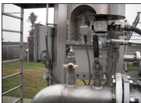
Figura 19: Beccuccio di prelievo del biogas
