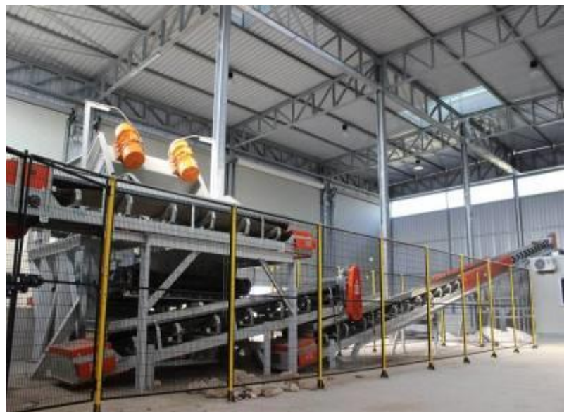
Fig. 5.5 – Impianto di trattamento rifiuti.
