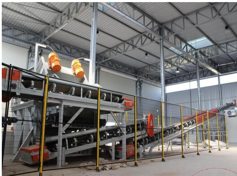
Fig. 5.5 – Impianto di trattamento rifiuti.
