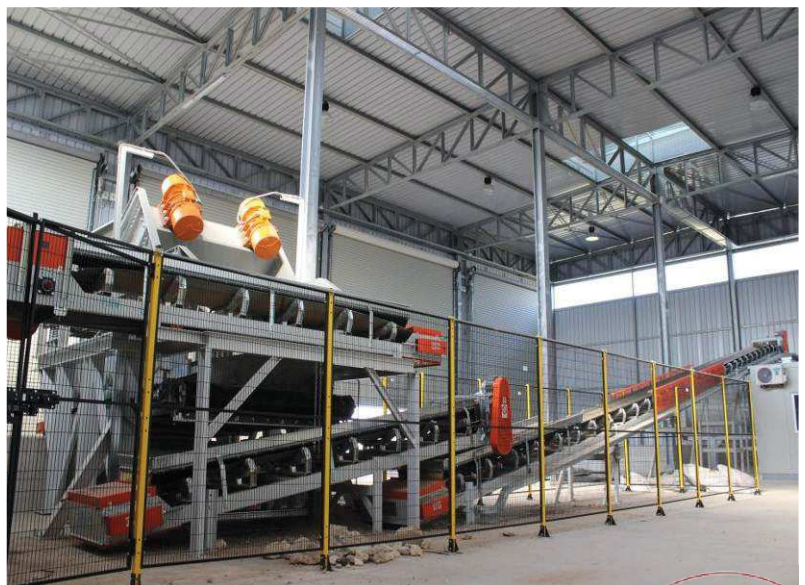
Fig. 5.5 – Impianto di trattamento rifiuti.
