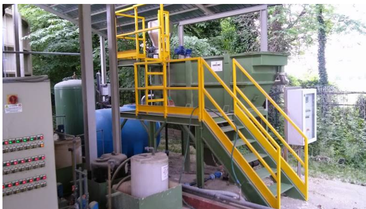
Figura 16: impianto di depurazione delle acque di pioggia lato est
