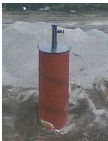
Figura 7: Pozzo di captazione del biogas
