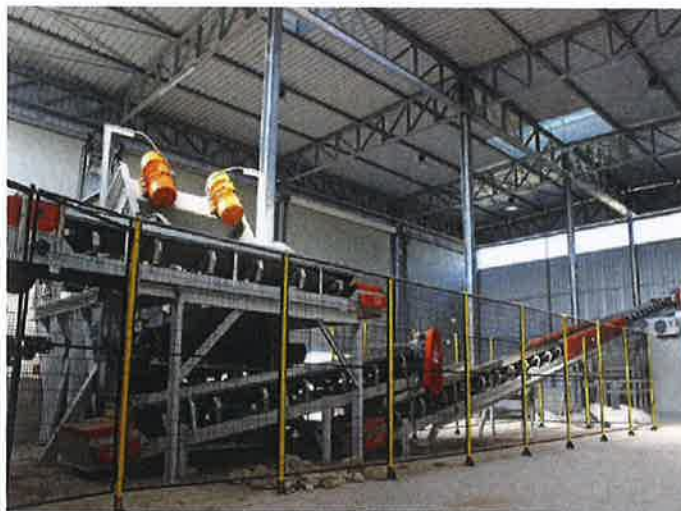
Fig. 5.5 – Impianto di trattamento rifiuti
