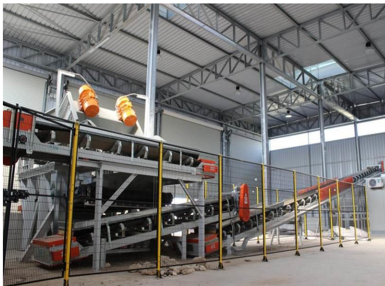
Fig. 5.5 – Impianto di trattamento rifiuti.
