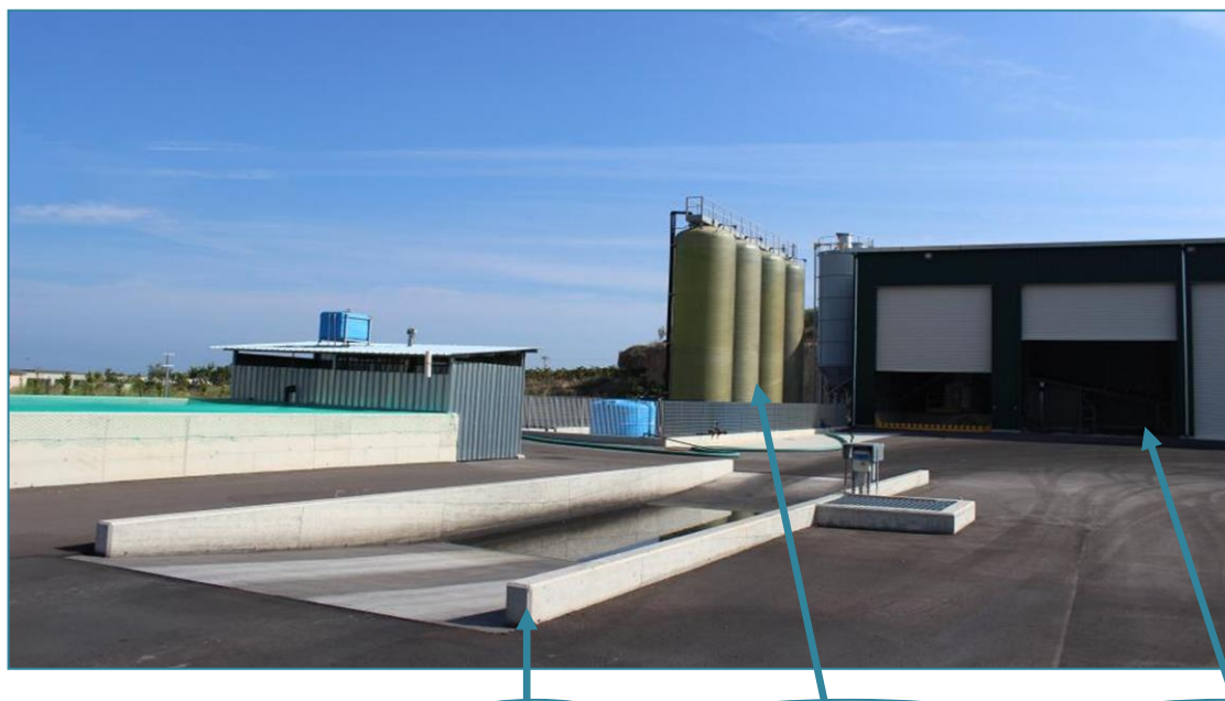
Fig. 5.4 – Alcune strutture di servizio: lavaggio ruote, serbatoi stoccaggio percolato, area trattamento rifiuti
